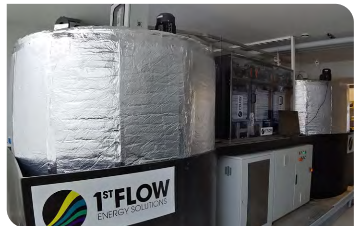
Vanadium-basierte Redox-Flow-Batterie mit Isolierung. (KIT/Felix Schofer)
